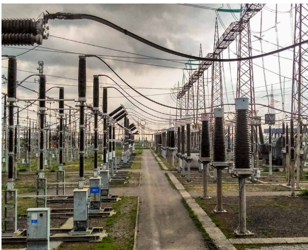
Bild 1: Anlagen der elektrischen Energieübertragung und -verteilung beinhalten unzählige elektrische Verbindungen, deren Zustand direkten Einfluss auf die Anlagensicherheit hat.
