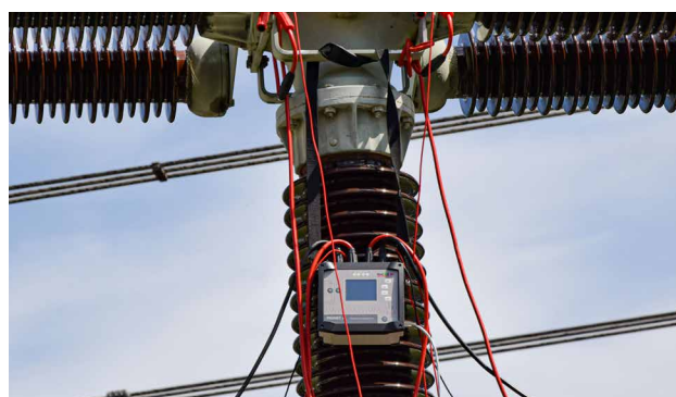
Bild 6: PROMET SE an einem Hochspannungsschalter mit zwei Unterbrechereinheiten.
