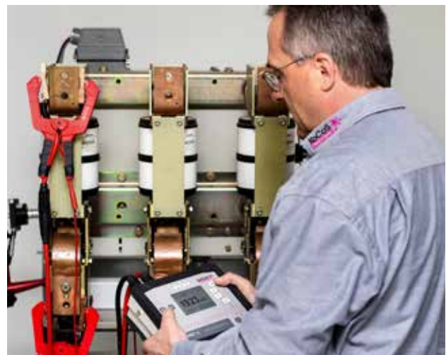
Bild 2: Statische Widerstandsmessung an den Unterbrechereinheiten eines Mittelspannungsschalters mit PROMET SE.
