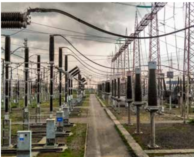
Bild 1: Anlagen der elektrischen Energieübertragung und -verteilung beinhalten unzählige elektrische Verbindungen, deren Zustand direkten Einfluss auf die Anlagensicherheit hat.
