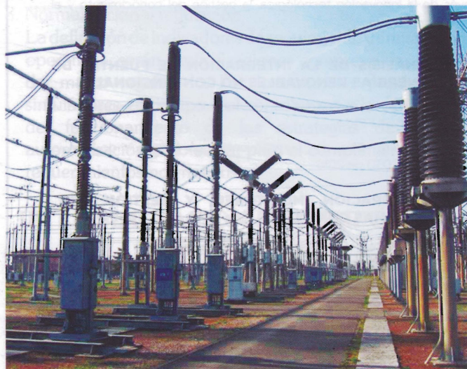
Fig. 1: Los interruptores están constantemente expuestos a factores externos, tales como el polvo, humedad, y fluctuaciones en la temperatura, los cuales pueden tener efectos negativos. Usualmente no han sido operados en años y tienen que operar confiablemente bajo condiciones de falla hasta 20 veces o más su corriente nominal en un corto periodo.
